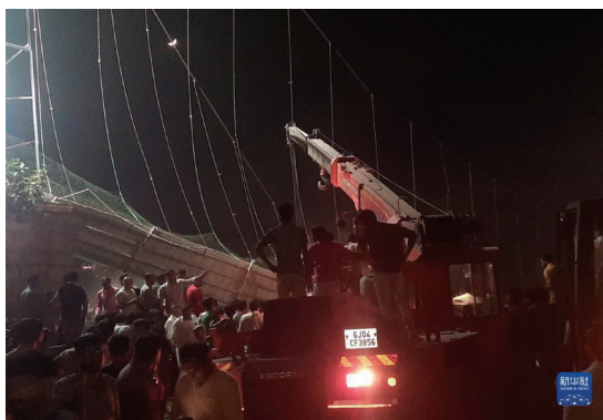
■ 图片来自新华社：2022 年 10 月 30 日，人们在印度古吉拉特邦莫比地区桥梁断裂事故现场进行救援
