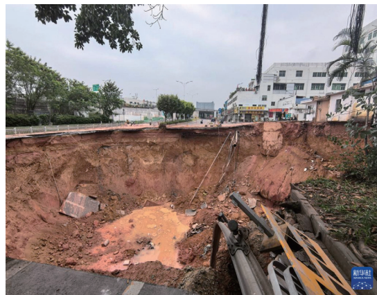
■ 图片来自新华社：2024 年 12 月 5 日拍摄的深圳深江铁路施工坍塌现场
