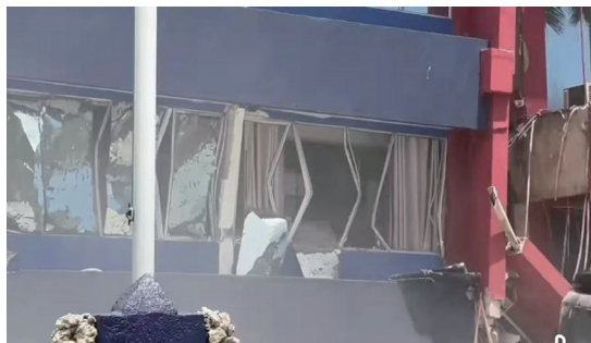
■ 图片来自新华社：2024 年 12 月 17 日在瓦努阿图首都维拉港拍摄的一座倒塌的建筑
