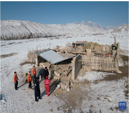
■ 图片来自新华社：1 月 24 日，在新疆阿合奇县库兰萨日克乡吉勒德斯村的一处牧业点，克州边境管理支队库兰萨日克边境派出所的民警和社会救援力量一起，排查走访震后受损房屋状况（无人机照片）
