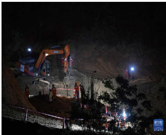
■ 图片来自新华社：5月2日晚，救援力量在广东梅大高速茶阳路段塌方灾害现场作业
