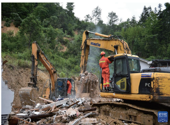
■ 图片来自新华社：6月23日，救援人员在湖南省新晃侗族自治县鱼市镇斗溪村龙塘组山体滑坡现场开展救援工作
