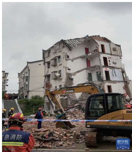
■ 图片来自新华社：5月27日拍摄的事故现场
